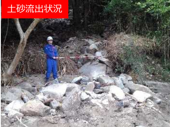
不安定土砂堆積状況
