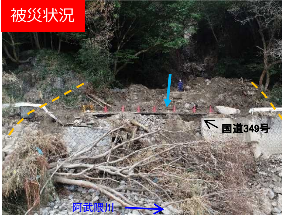
不安定土砂堆積状況
