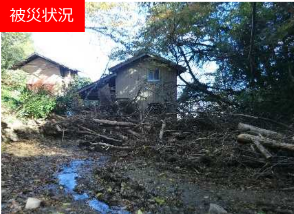
不安定土砂堆積状況
