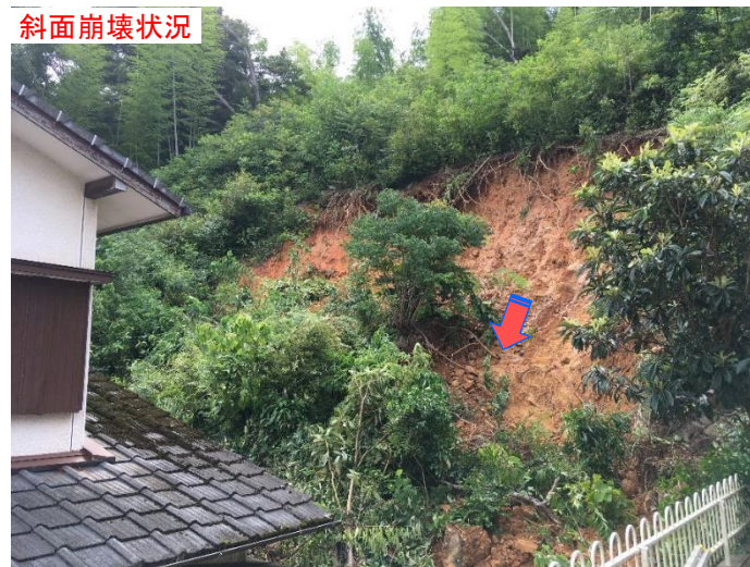
斜面崩壊状況
