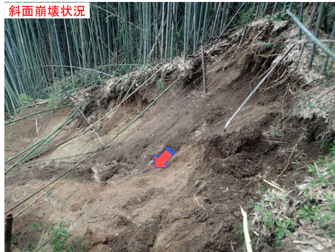
斜面崩壊状況
