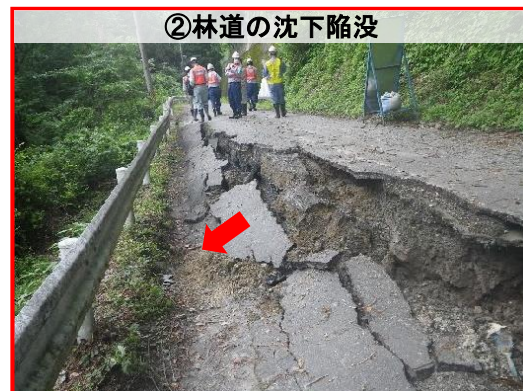
③県道の亀裂段差
