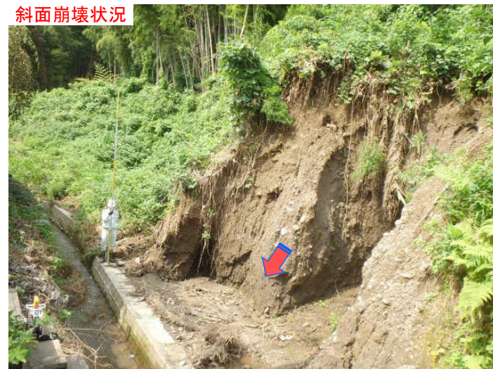
斜面崩壊状況
