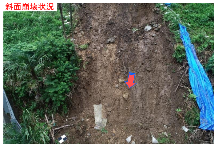
斜面崩壊状況
