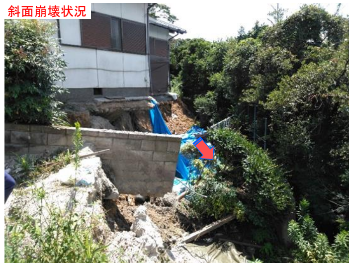
斜面崩壊状況
