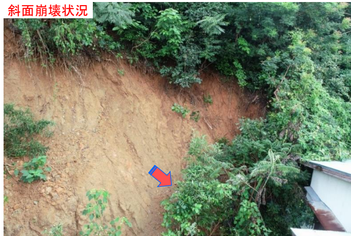
斜面崩壊状況
