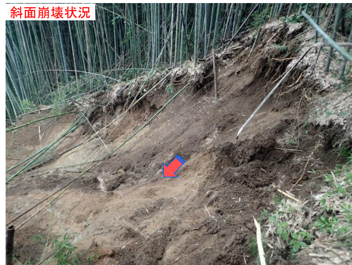
斜面崩壊状況
