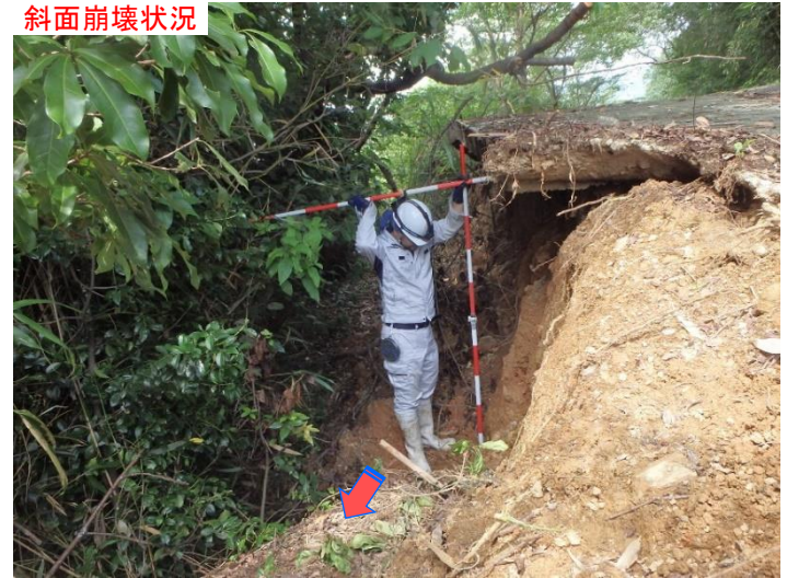
斜面崩壊状況
