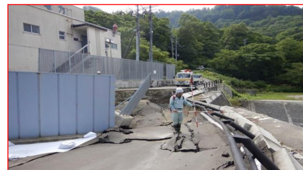
村道の隆起・亀裂
