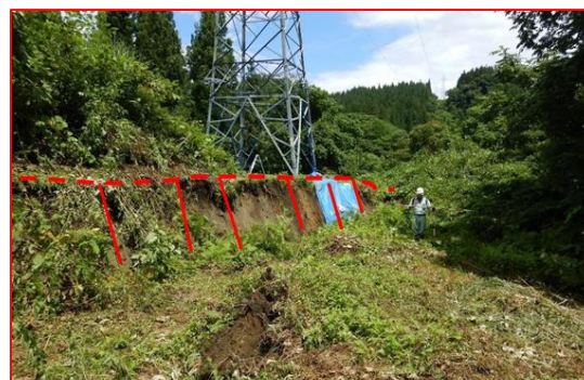
地すべり地内の陥没
