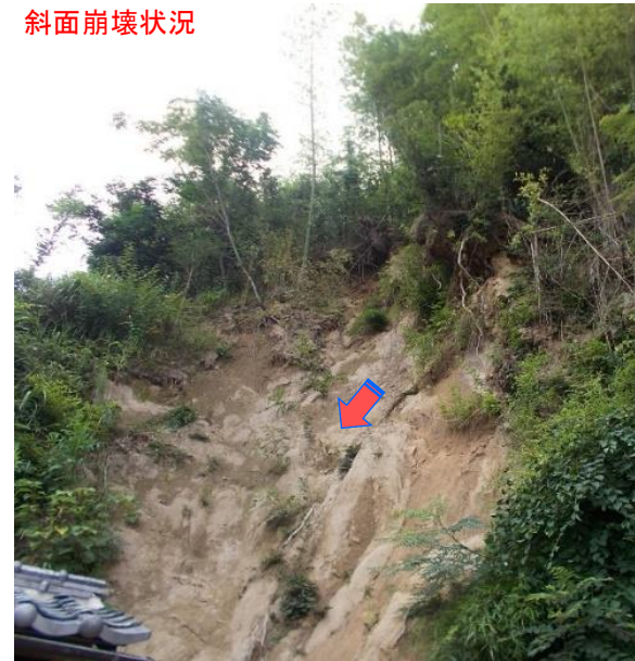
斜面崩壊状況
