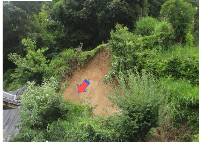
斜面崩壊状況
