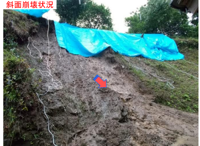
斜面崩壊状況
