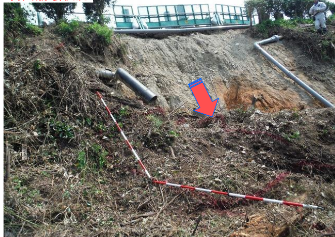
斜面崩壊状況
