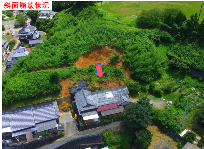
斜面崩壊状況
