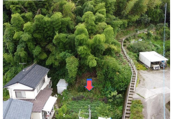
斜面崩壊状況
