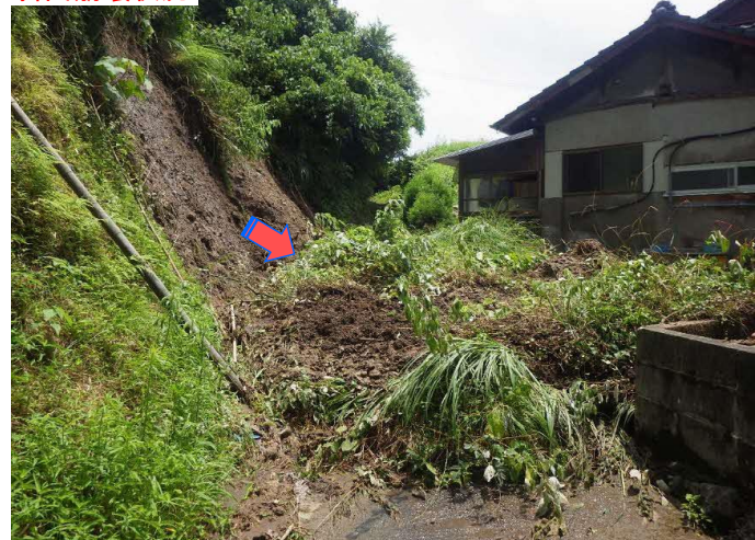
斜面崩壊状況
