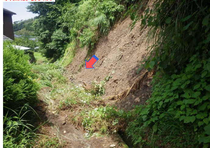
斜面崩壊状況
