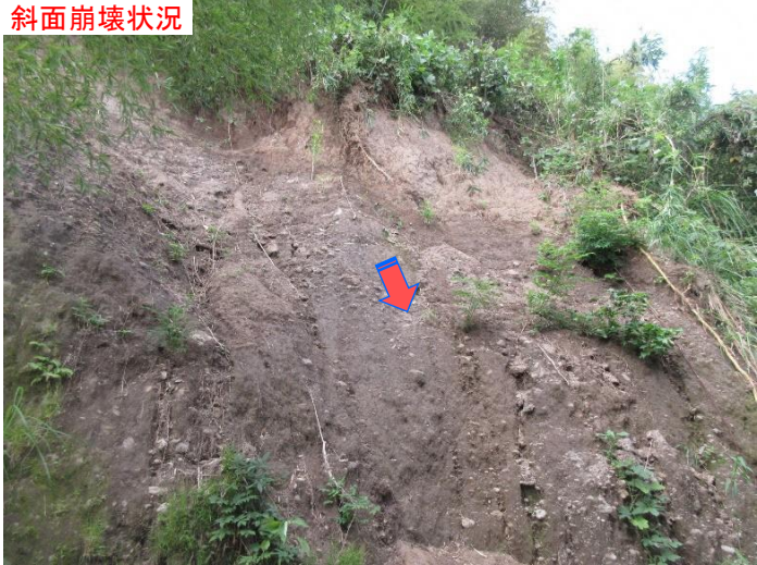
斜面崩壊状況
