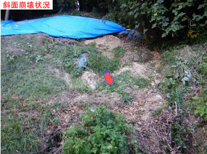
斜面崩壊状況
