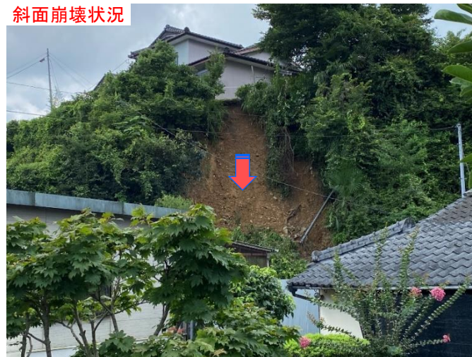
斜面崩壊状況
