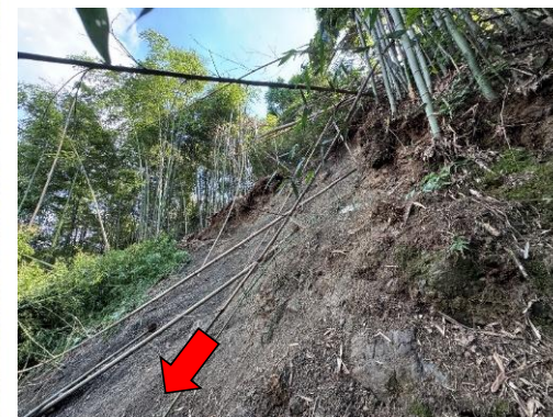
斜面の崩壊状況(崩落箇所近景)
