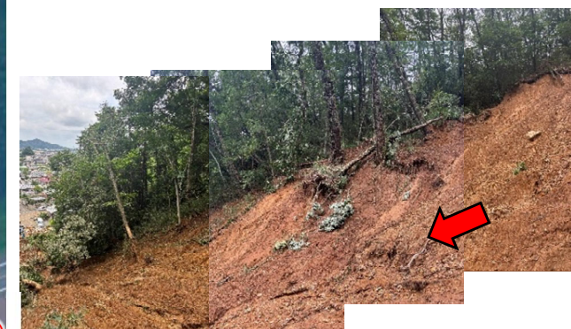
斜面南側の崩壊状況(斜面上部滑落崖)
