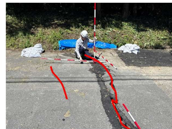
②市道の亀裂状況
