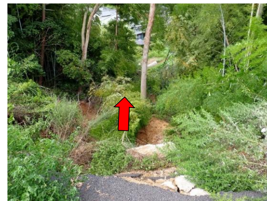
斜面の崩壊状況(斜面頭部から崖下を望む)
