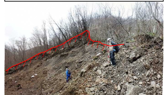
頭部滑落部の状況
