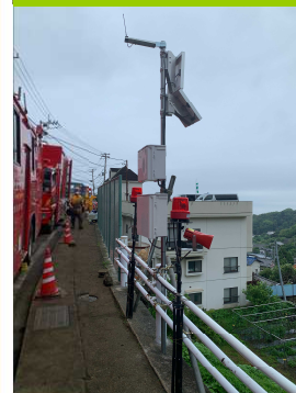
サイレン等の設置状況
