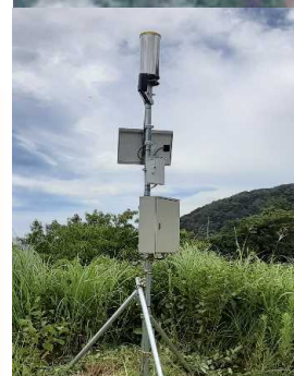
雨量計設置状況
