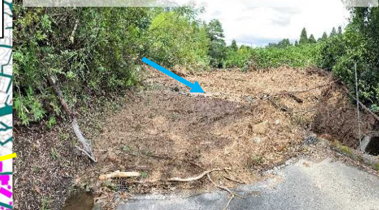
被害状況：太田川水系西山本川(その2)
