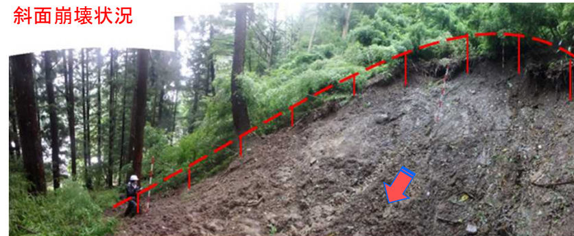
斜面崩壊状況
