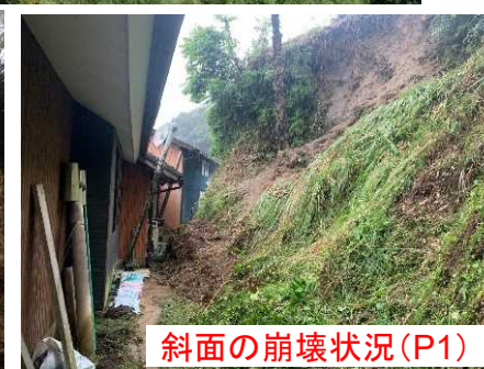
斜面の崩壊状況(P2)
