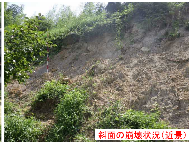
斜面の崩壊状況(全景)
