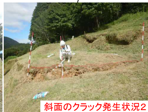
斜面のクラック発生状況
