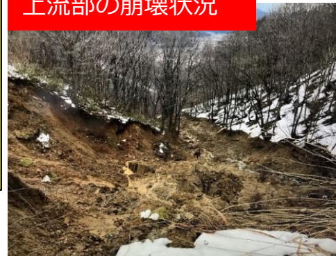
上流部の崩壊状況
