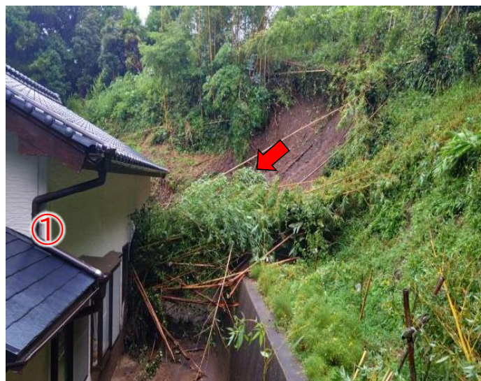
崩土・倒木の堆積状況
