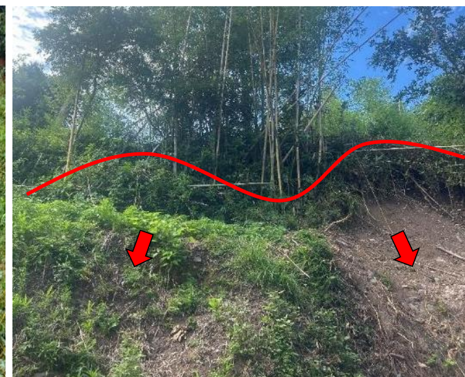
斜面の崩壊状況(滑落崖)
