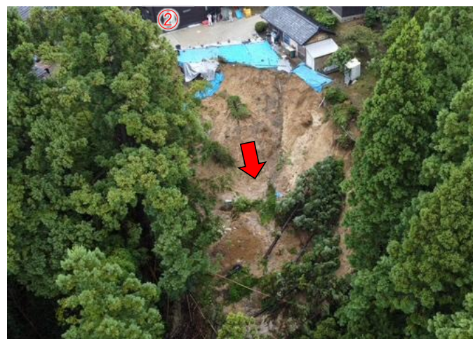
斜面の崩壊状況(正面)
