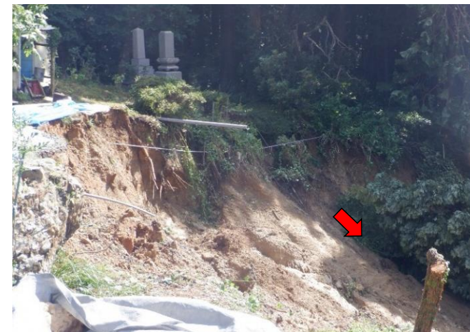
斜面の崩壊状況(滑落崖)
