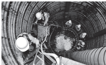
写真－5 集水井内の見学（天竜川上流河川事務所）
