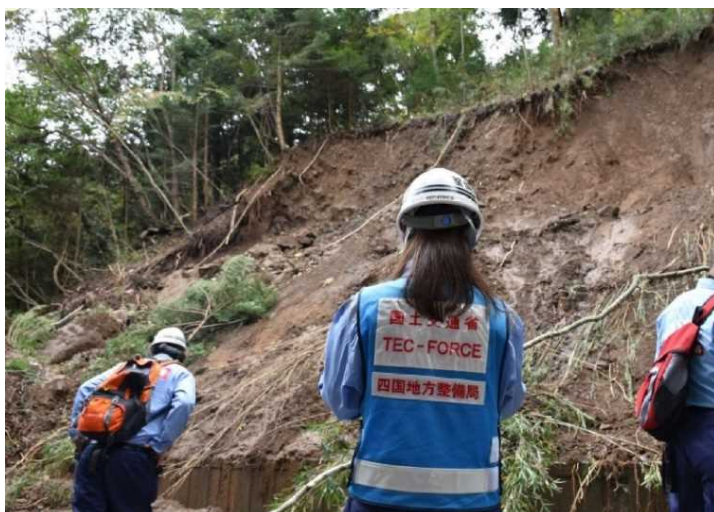
被災状況調査 【福島県相馬市】 (四国地方整備局)
