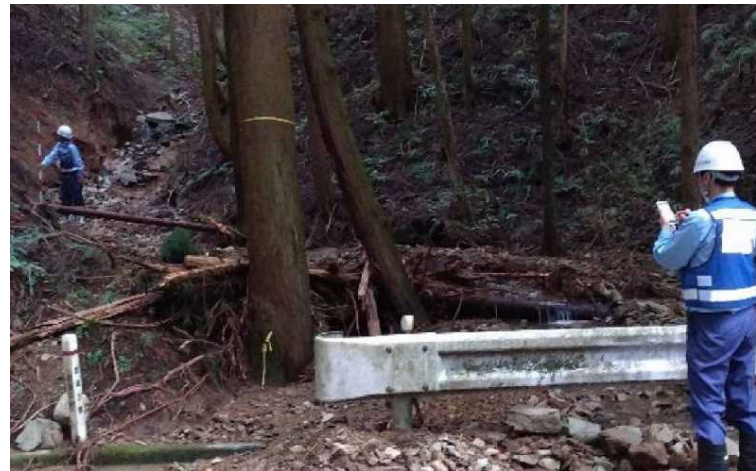
土砂崩落箇所調査 【埼玉県比企郡ときがわ町】 (中国地方整備局)
