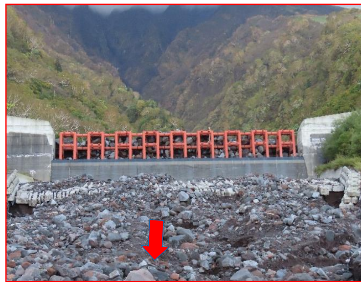
土石流発生後
