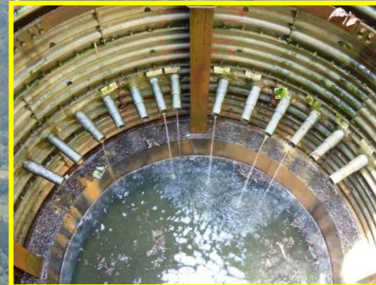
同地区内の既設集水井工
