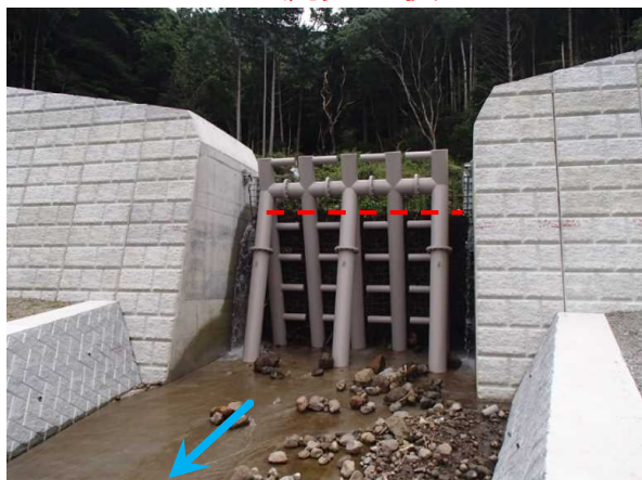
土石流発生後
