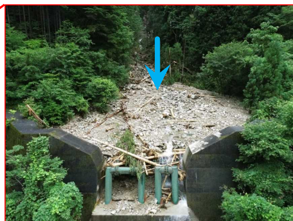
土石流発生後(近景)
