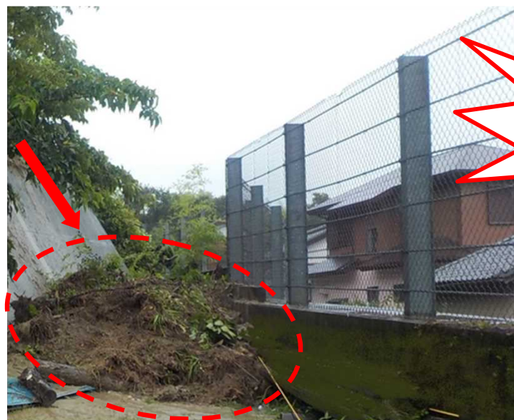
土砂捕捉状況
