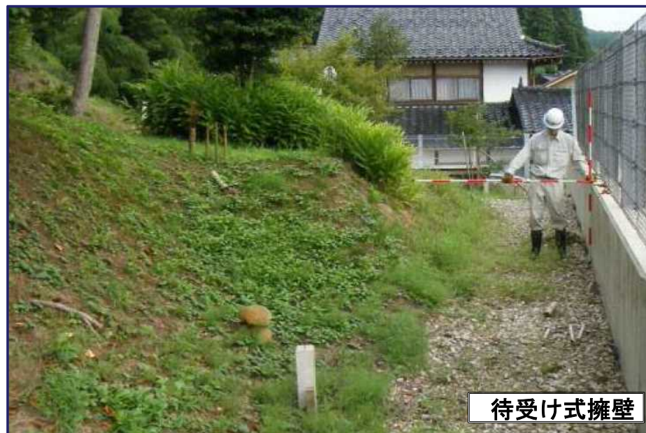
がけ崩れ発生前 (H20.9.6)
