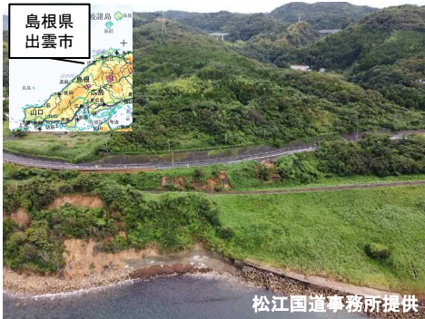
松江国道事務所提供 災害全景写真
