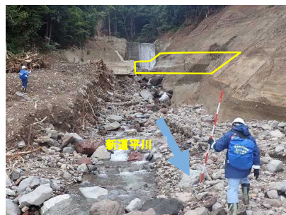
【新道平川 現地踏査(治山堰堤被災)】
