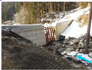
土石流発生前 (R4年3月)
