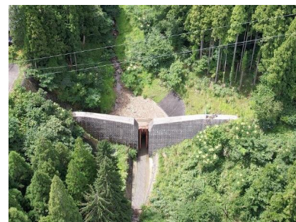
土石流発生直後
