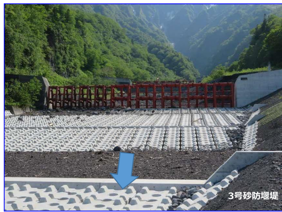
土石流発生前(令和5年6月12日 撮影)
