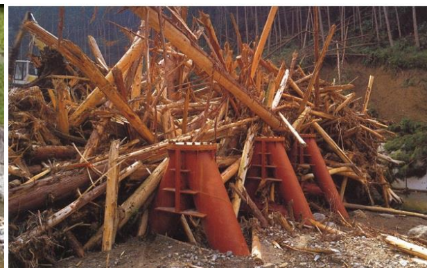
流木捕捉工(大分県中津市)
