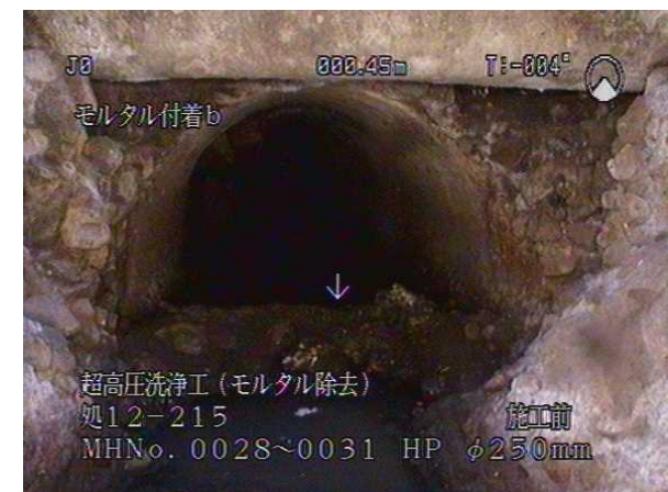
モルタル詰り
