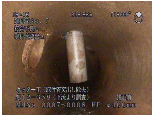
取付管の突起
