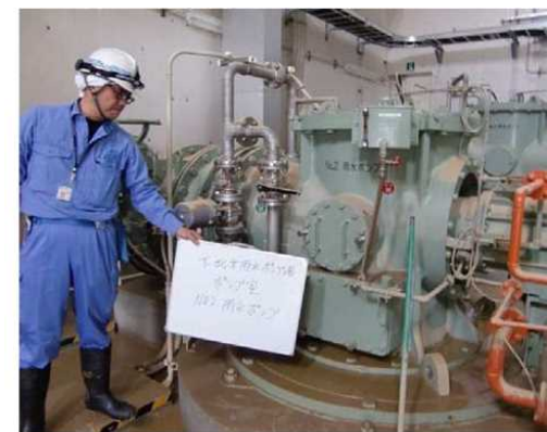
ポンプの浸水状況 (広島県三原市)
