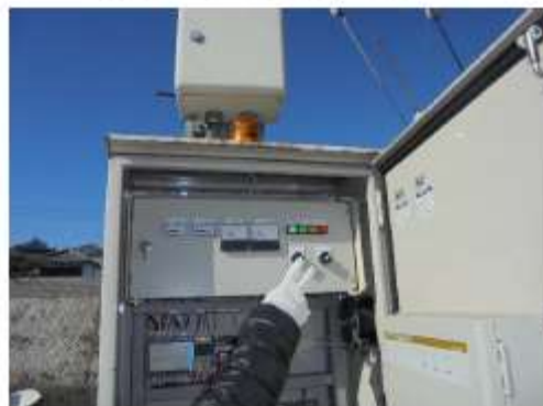
⑩制御盤内のブレーカー類を切にする
