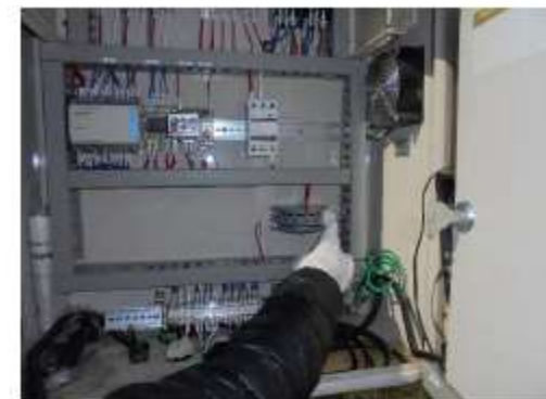
⑬-1制御盤内の電源プラグと延長コードを抜く
